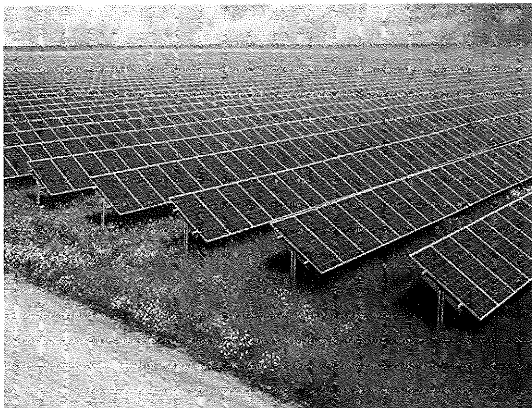
Слика 38. Изглед на фотоволтаична електроцентрала вклопена во локалниот предел
